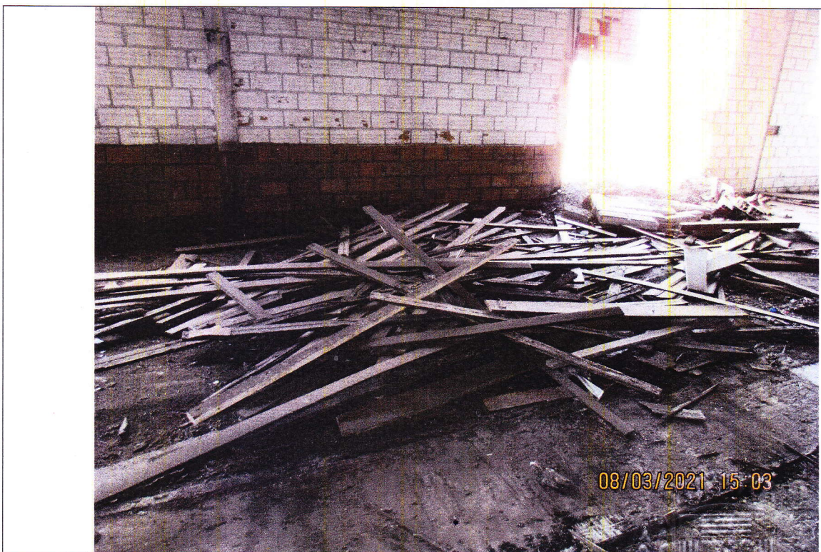
Imagem 10 – Assoalho removido – Constatado apodrecimento e madeira comida por cupins
