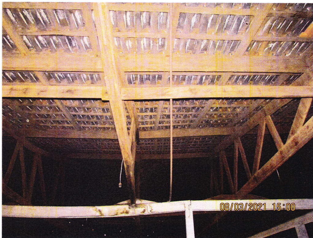
Imagem 05 – Estrutura do telhado – Atenção ao envergamento
