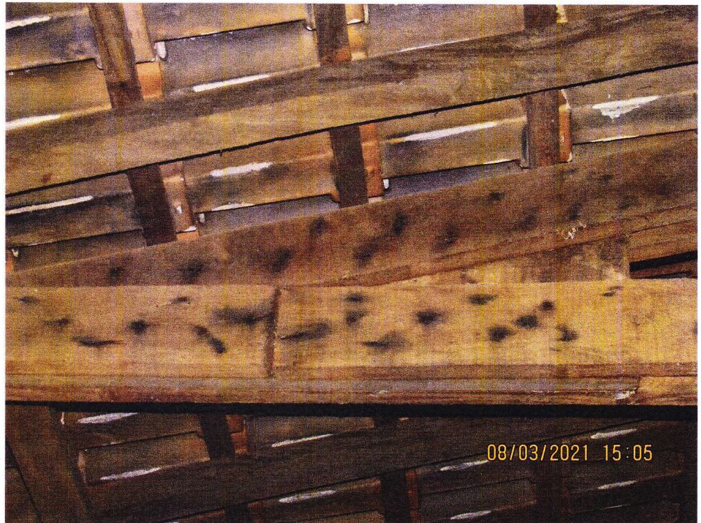
Imagem 07 – Atenção a quantidade de pregos (manchas escuras sob a madeira pontos escuros)
