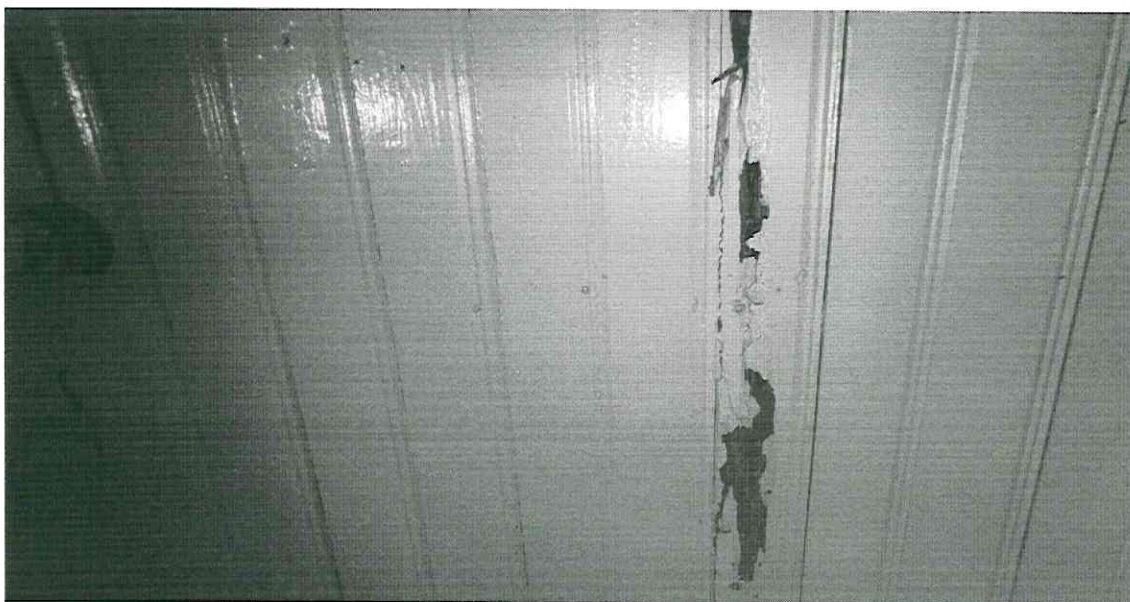
Foto 05 – Parede na parte central do corpo da casa, divide sala e dois quartos, comprometimento por cupim
