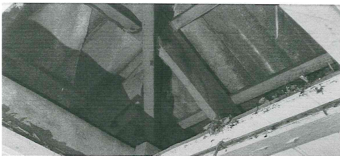
Foto 04 – Alçapão na parte interna da casa, presença de cupins no forro e estrutura de sustentação do telhado
