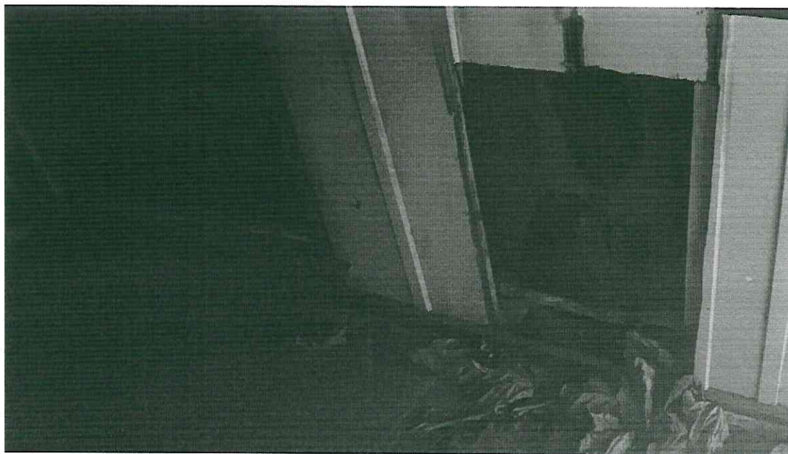
Foto 08 – Vista externa, comprometimento do fechamento interno e externo da parede dupla.
